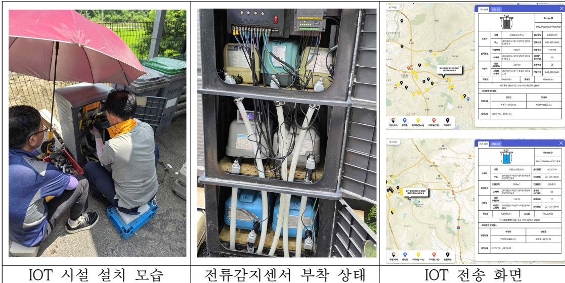
[그림 20] IOT 시설 설치 및 설치된 모습, 전송된 화면 모습
